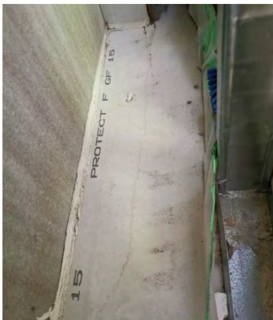
Mynd 16: Vatnsummerki á yfirborði brunalokunar á vesturhlið.
