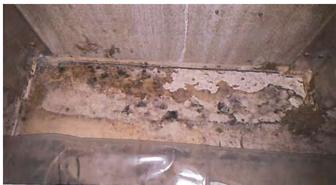
Rakaskemmdir á bakhlið Viroc plötu og á yfirborði brunaloku milli hæða.
