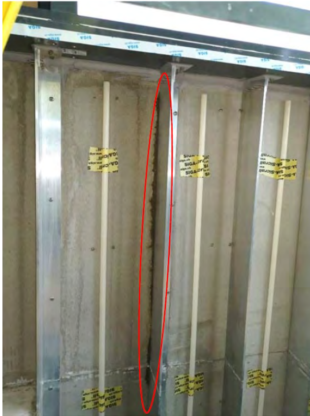
Mynd 13: Vatn kemur inn um samskeyti tveggja Conchip platna á norðaustur enda byggingar.
