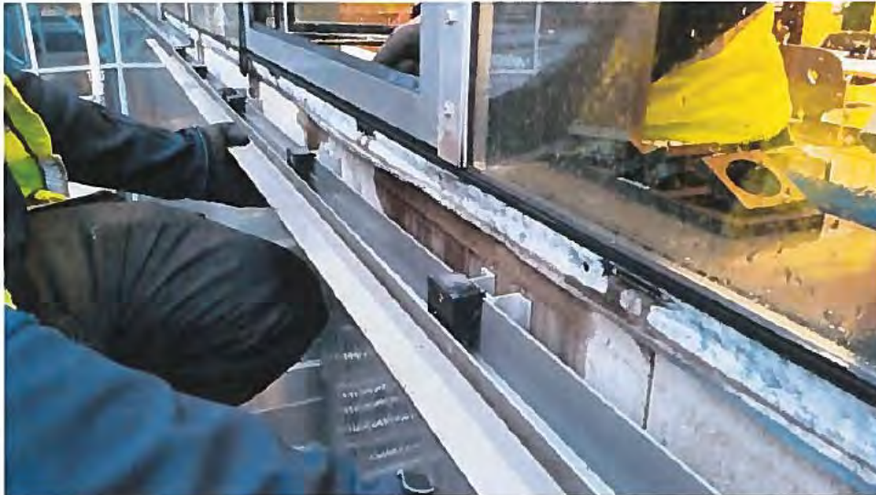
Mynd 21: Gluggakerfið var skoðað á 3. hæð á norðurhluta austurhliðar. Þéttiborðar eru yfir gluggafölsum en ná ekki vel niður á VIROC plötur sem eru of stuttar og ná varla upp á þéttlista í gluggafalsi. Vatn safnast inn í gluggafalsi og á ekki greiða leið út þar sem drenleiðir eru langar. Engin sjáanleg drenun er hugsuð út gluggafalsi önnur en drenun undan gleri. Sjá má mikinn raka úr falsi og utan á VIROC plötum á móts við lóðréttan póst og lekastað innanhúss.
